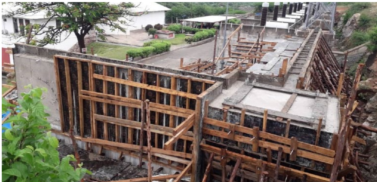
پروژه پست 10MVA و 220/33 KV، نیاکانازی، تانزانیا
